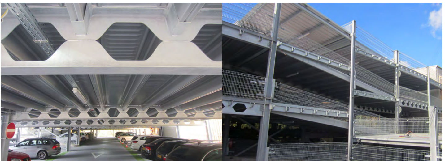
Abbildung 5: Lochstegträger im Parkhaus Enovos, Esch/Alzette
